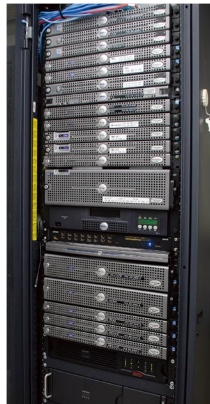
函館大学のサーバ・ラック
