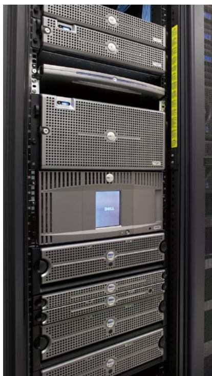
ニコン熊谷製作所のサーバールーム。
